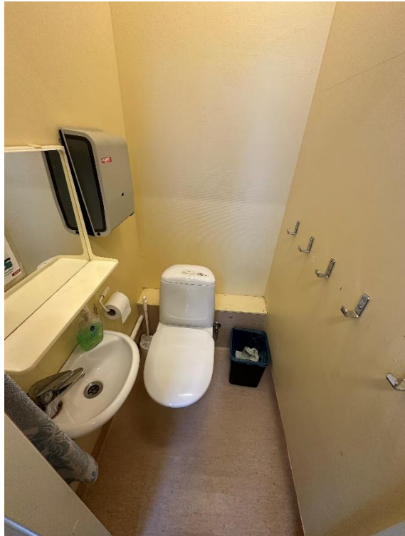
Kuva 34. Vesikalusteet hyväkuntoiset. Viemäreiden ja vesijohtojen asennusvuodesta ei tietoa
