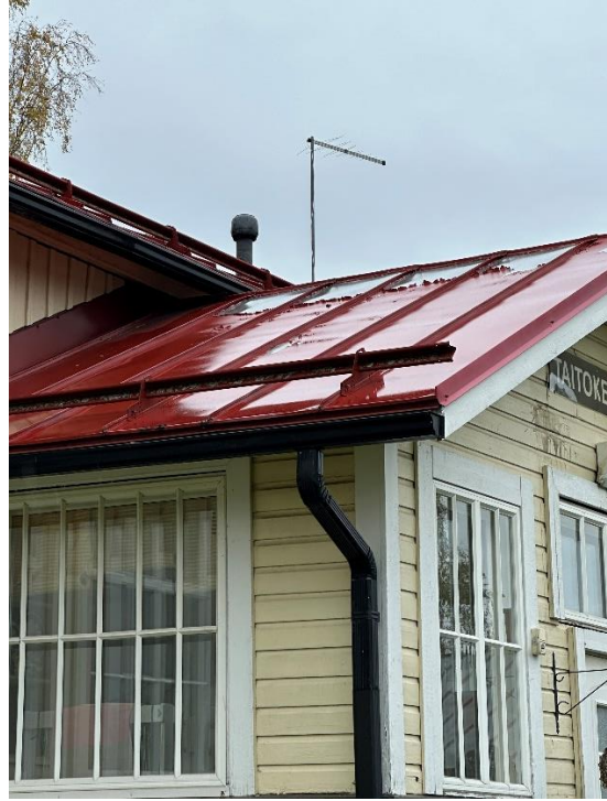
Kuva 2. Peltikatteen maalipinta eteisalueen osalta heikossa kunnossa
