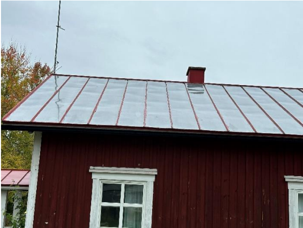
Kuva 17. Etelälappeen maalipinta huonossa kunnossa
