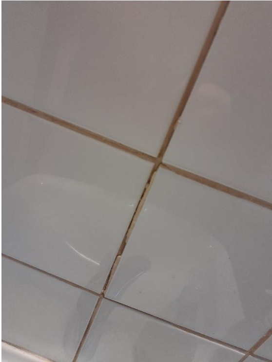
Kuva 21. WC:n laatoituksen saumoissa lohkeamia
