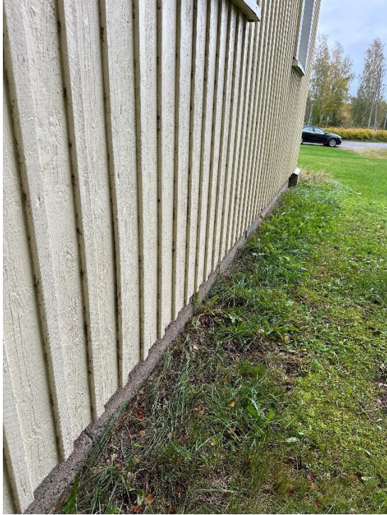
Kuva 1. Ulkoverhous silmämääräisesti arvioituna tyydyttävässä kunnossa
