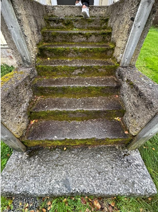
Kuva 5. Pohjoispäädyn ulkoportaait ja kaiteet tulee kunnostaa
