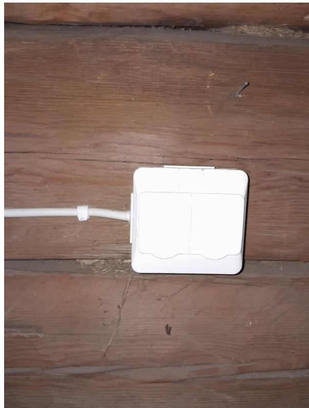
Kuva 46. Aittakahvilassa muutamia pistorasioita ja valaisimia
