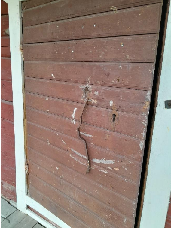
Kuva 29. Ulko-ovet tulee kunnostaa
