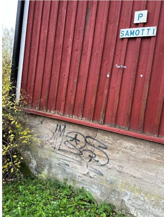
Kuva 14. Rakennukselle tehty ilkivaltaa
