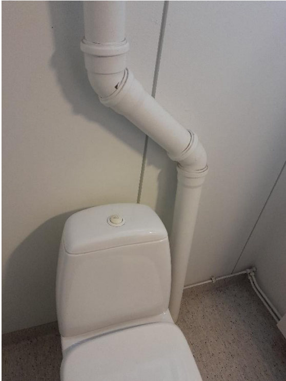
Kuva 37. Viemärin tuuletusputki WC-tilassa
