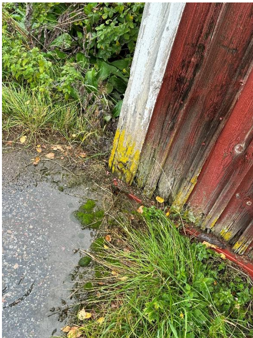
Kuva 11. Sokkeli maanpinnan alapuolella, maanpinta ulkoverhouksen tasossa, ei sadevesikaivoja, puuverhoilu erittäin vaurioitunut
