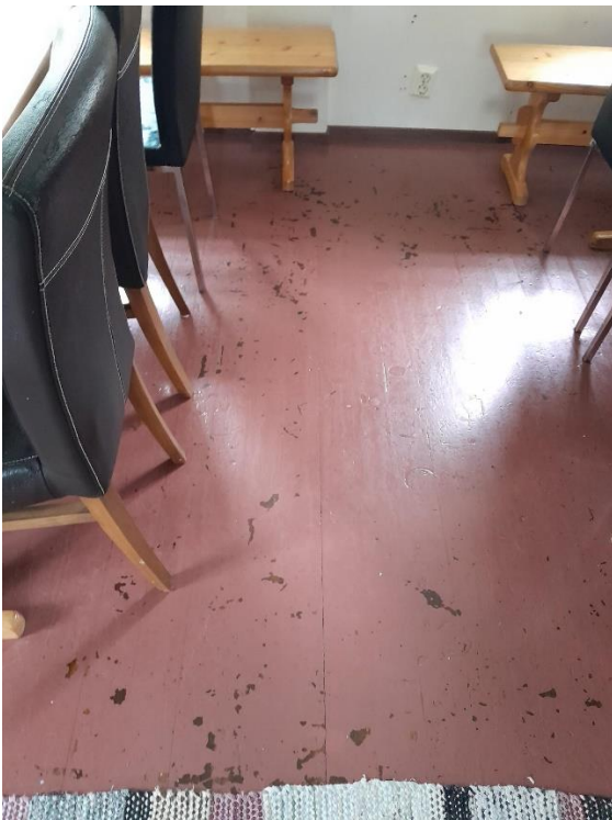
Kuva 23. Lattian maalipinta paikoitellen kulunutta
