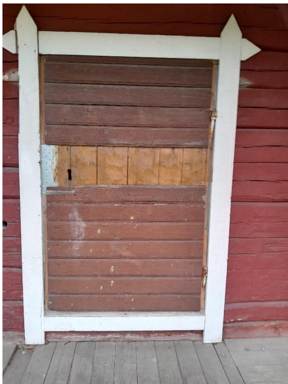
Kuva 27. Ulko-ovi tulee kunnostaa
