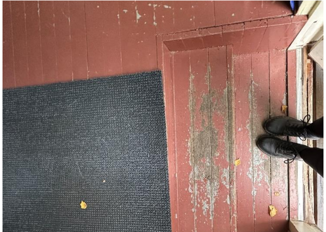
Kuva 18. Lattian maalipinta paikoitellen erittäin kulunut
