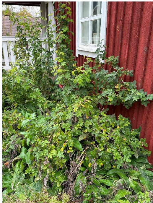
Kuva 12. Kasvillisuutta julkisivussa kiinni
