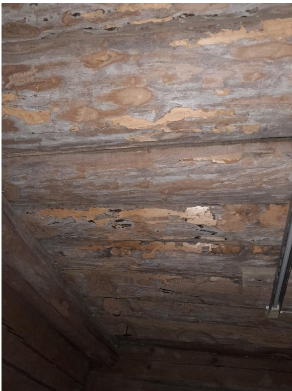
Kuva 31. Yläpohjan hirret ovat suhteellisen hyväkuntoiset
