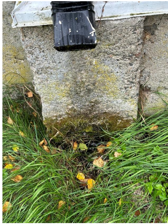
Kuva 4. Sadevesijärjestelmä on syytä nykyaikaistaa. Roiskevesi aiheuttaa kosteusrasitetta sokkeliin
