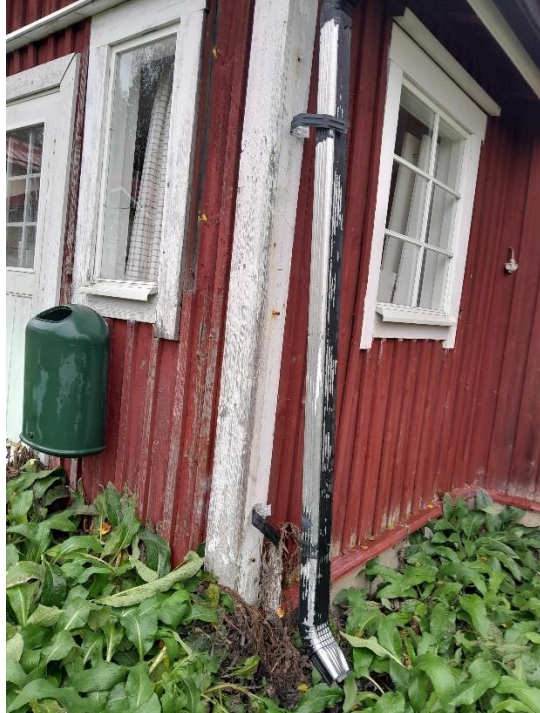
Kuva 10. Syöksytorvet irti kannakkeistaan, maalipinta huono ja julkisivussa kosteudesta johtuvia jälkiä.
