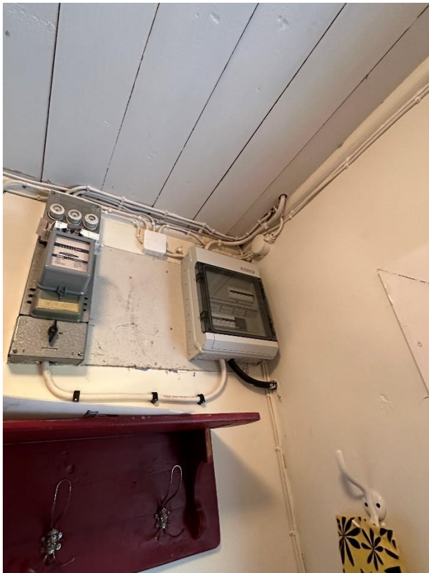
Kuva 43. Tapolan pirtin sähkökeskus
