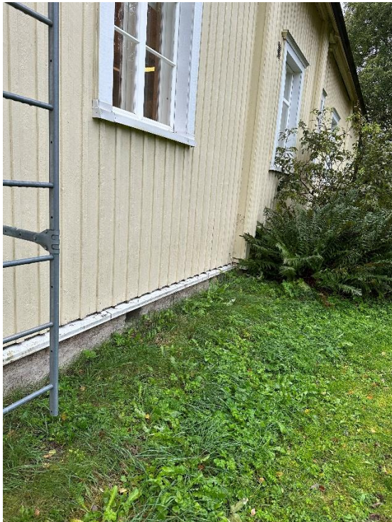
Kuva 3. Kasvillisuutta kasvaa julkisivussa kiinni ja maanpinnat kaatavat paikoitellen sokkeliin päin
