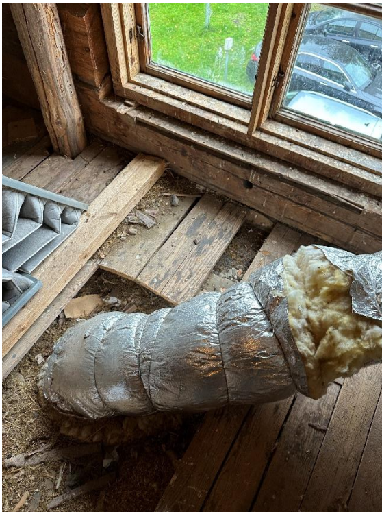
Kuva 7. IV-putken eristeet rikki
