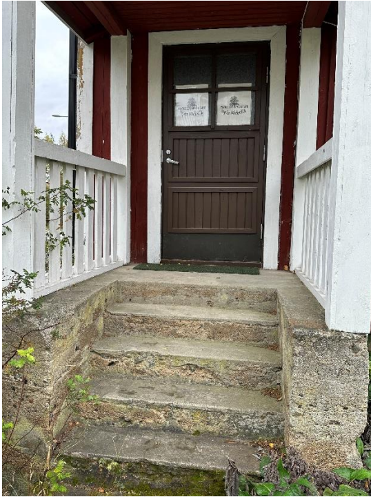
Kuva 13. Ulko-ovet mahdollisesti uusittu vuoden 2008 peruskorjauksessa. Ulkoportaat kunnostuksen tarpeessa
